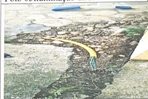
Foto 05- cabo energizado aparente
