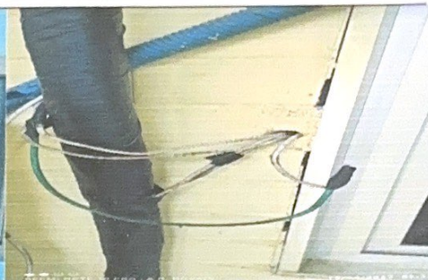
Foto 11- cabos de alimentação exposto
