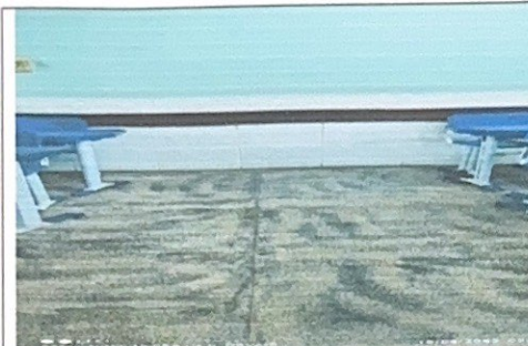
Foto 01- piso em granilite
