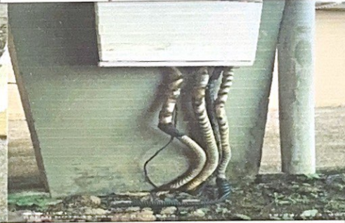
Foto 07- conduites corrugado exposto
