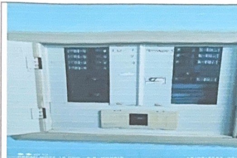
Foto 10- disjuntores antigos fora de padrão
