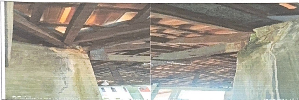
Foto 18- madeira do telhado comprometida
