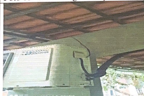
Foto 08- cabos de alimentação exposto
