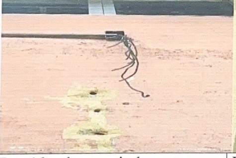
Foto 16- cabos sem isolamento
