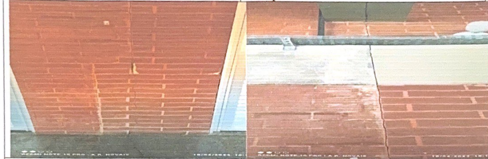
Foto 20- junta de delatação
