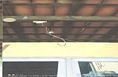
Foto 09- cabos de alimentação exposto
