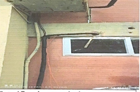
Foto 17- cabos sem isolamento
