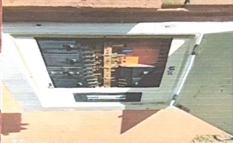
Foto 13- quadro de distribuição
