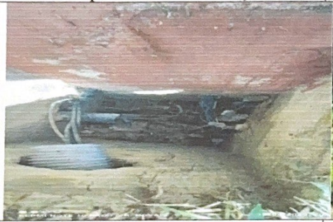
Foto 14- caixa de passagem elétrica
