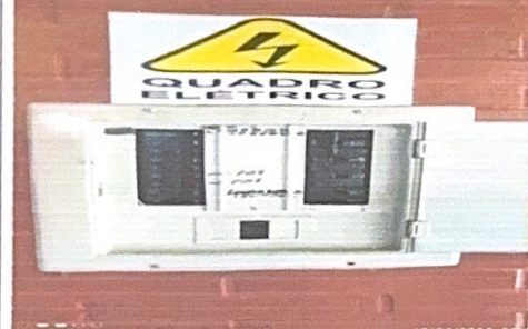
Foto 12- quadro de distribuição
